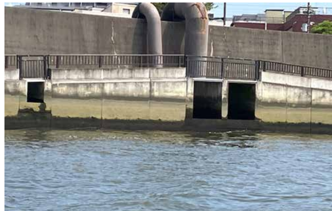
写真4 旧江戸川河口の浦安市排水口；夜間に排水される由 2023年9月16日
