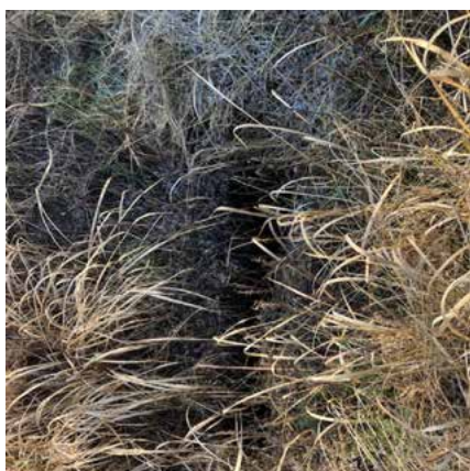
写真14 排水路は雑草に隠れて奥が見えない 同日
