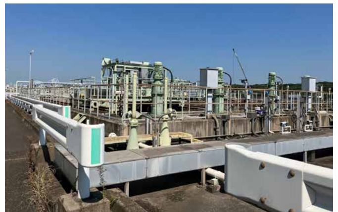
写真6 中央堤防外側埋め立て処分場の第三排水処理場 2023年7月23日 著者撮影
