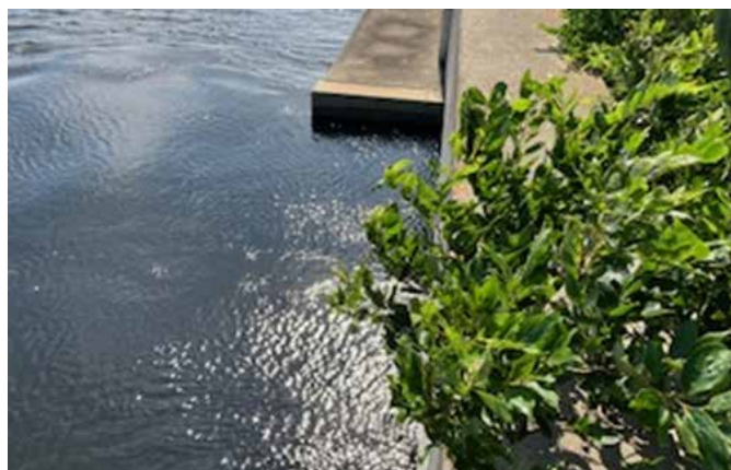
写真4 塩素処理後砂町運河に放出される砂町水再生センター排水 2023年7月12日 著者撮影
