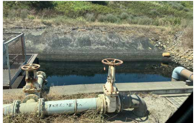
写真5 中央堤防外側埋め立て処分場内の排水ポンプと調整池 2023年7月26日著者撮影
