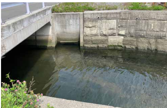
写真5 大船渡浄化センターからの排水が流れ込む排水路への口 2023年6月27日
