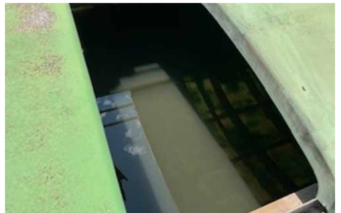
写真2 第1沈殿槽での沈殿の様子 2023年7月12日
