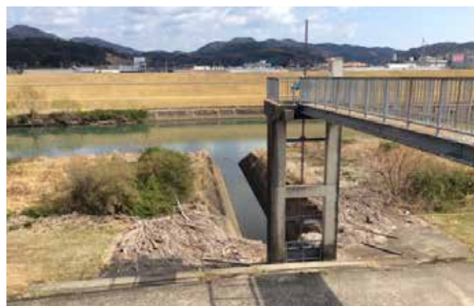
後川の右山排水機場の排水口 2022年3月14日
